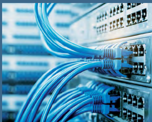
Redes Multimedia y Telecomunicaciones
