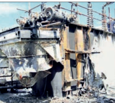
Figura 1 Un fallo prácticamente catastrófico dañó un transformador.
