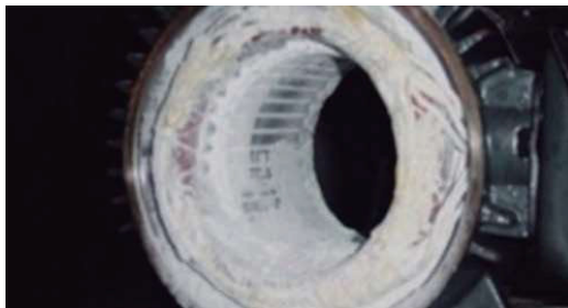
Figura 6. Exceso de contaminación interna
