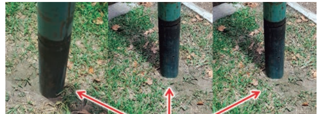
Columnas sin conductor de protección y por ello no conectadas a tierra.
