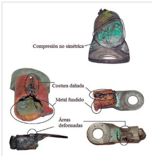
Figura 7. Daños en terminales de motores de BT (Fuente: EASA).
