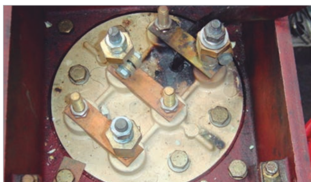
Figura 4. Motor con falla producto de un problema en la conexión.
